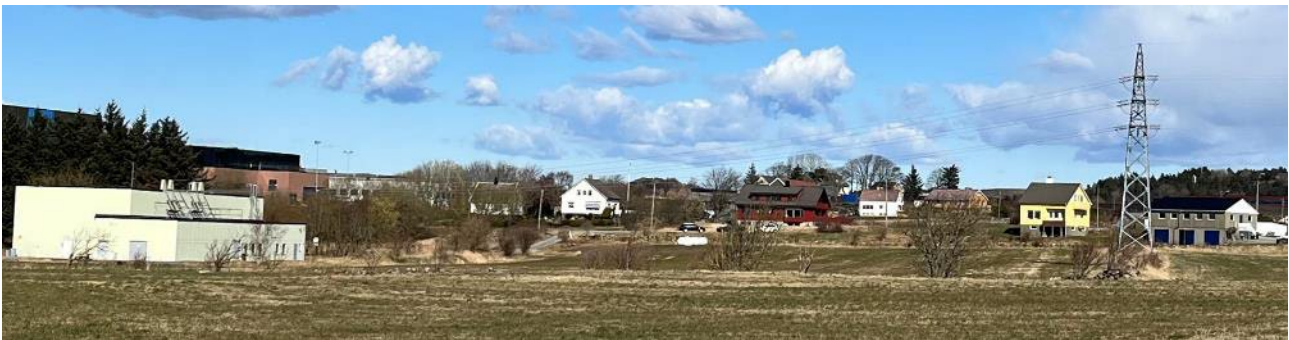
Figur 5-33 Dagens stasjon og kraftledning. Portalmasten til høyre har vertikaloppheng og linene termineres i dagens stasjon med planoppheng. Linene går fra tre nivåer i masten til ett nivå ved bygget (Foto: Multiconsult).
