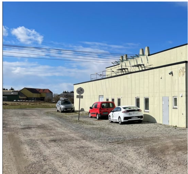
Figur 3-5 Planoppheng i Risavika transformatorstasjon (Foto: Multiconsult).
