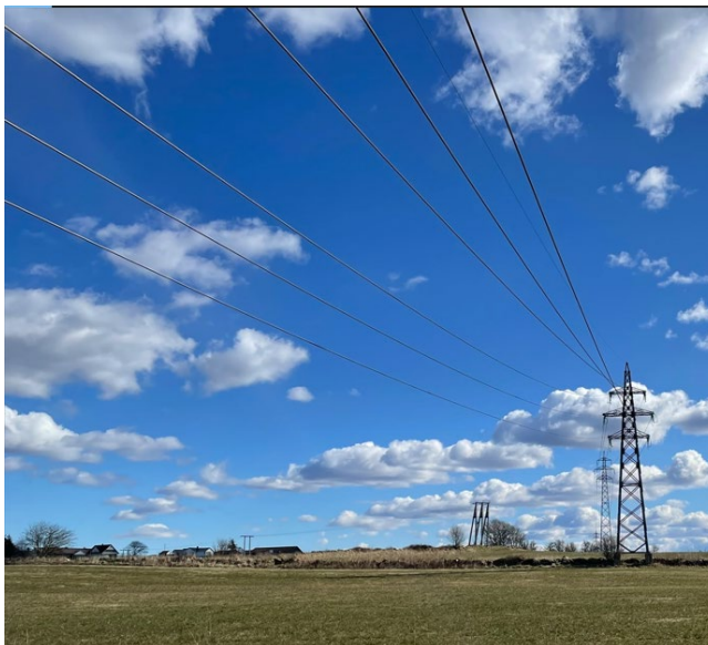
Figur 3-4 Vertikaloppheng i siste mast før Risavika transformatorstasjon (Foto: Multiconsult).
